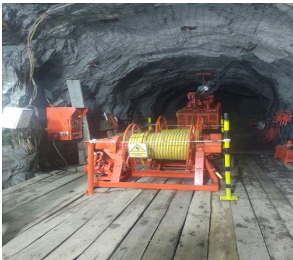
Installation zur besseren Belüftung des Stollens, Macdesa Peru. Bild: Macdesa
